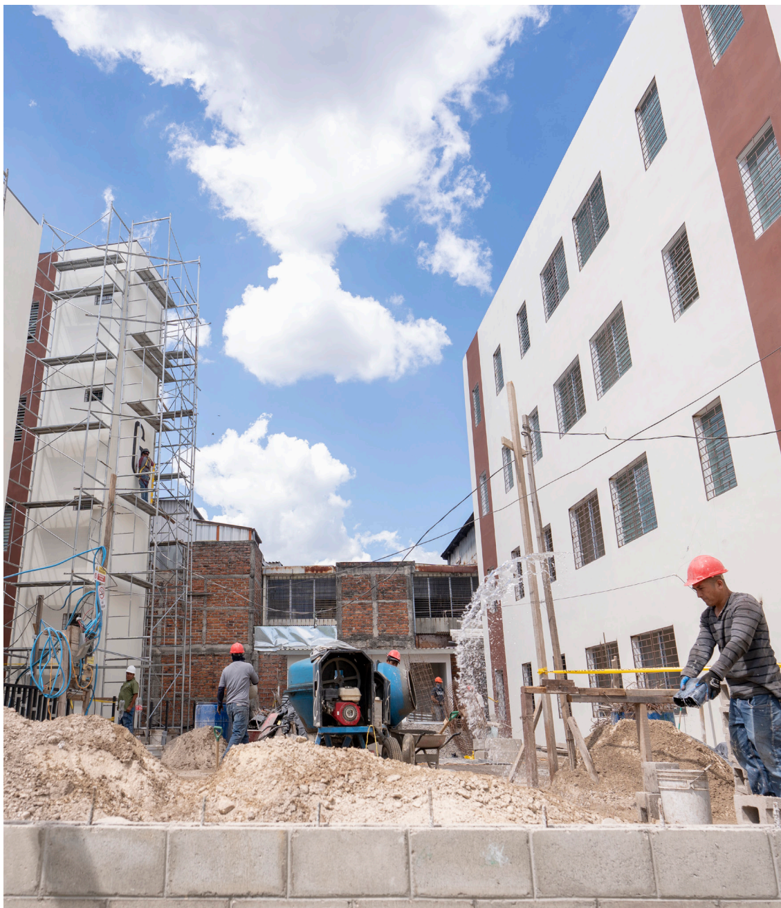
Riqualificazione di 64 alloggi di edilizia sociale nel centro storico di San Salvador - Marzo 2025
